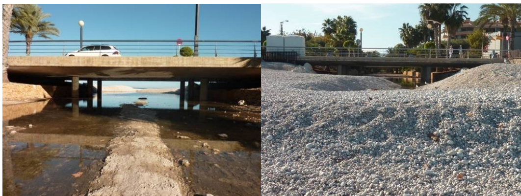
Desembocadura artificial de la rambla de l'Albir Figura 3.99. Barrera costera de gravas cegando la desembocadura de la rambla de l'Albir, vista desde la orilla del mar.
